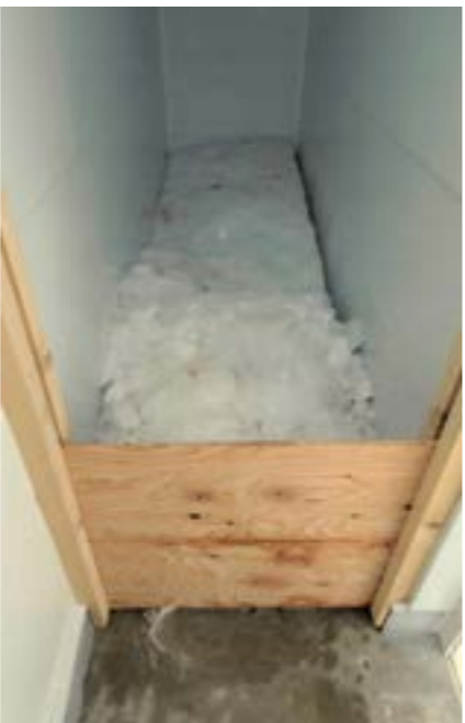
1階の両サイドに設置した雪室の内部。入り口付近にはヒバの棚も設けられ、野菜や果物の貯蔵庫として利用できる
